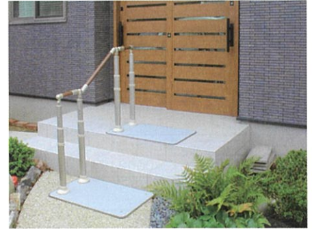
設置商品 AT-C-630 築3年の戸建。 階段の移動補助として使用。
